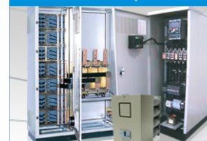
Bancos de capacitores
